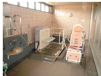
「機械（リフト）浴室」
